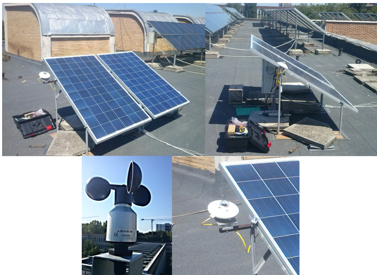
Imagini cu sistemul experimental instalat pe acoperișul Facultății de Inginerie Electrică
